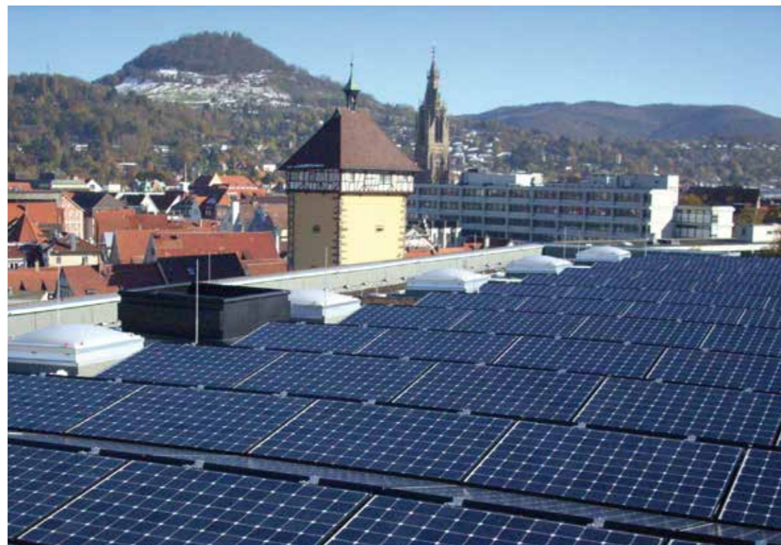
Solarstromanlage der EENA eG auf der Stadthalle Reutlingen (Bild: Schöffalter)
